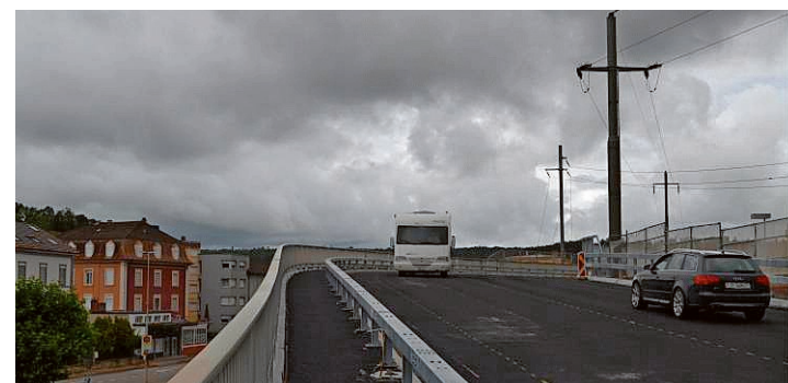
Les travaux, dont le marquage au sol, ne sont pas encore entièrement terminés, mais le trafic a repris hier.
